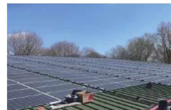
Dach o niskiej nośności Holandia | 500kW
