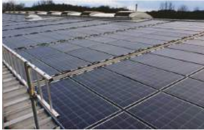
Dach o niskiej nośności Niemcy | 460kW
