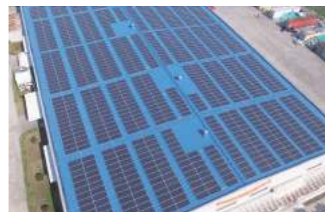
Dach o niskiej nośności Szanghaj, Chiny | 600kW
