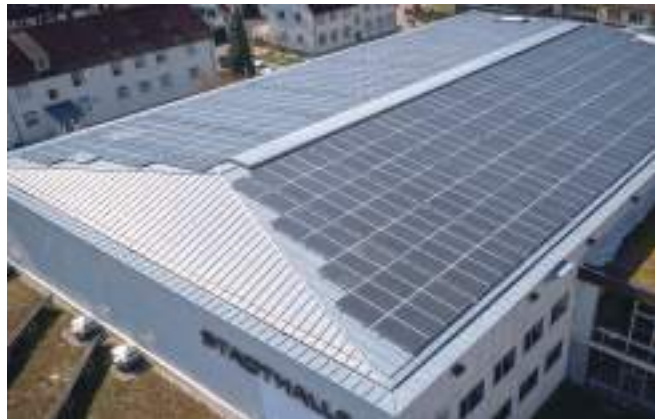
Dach o niskiej nośności Niemcy | 245kW
