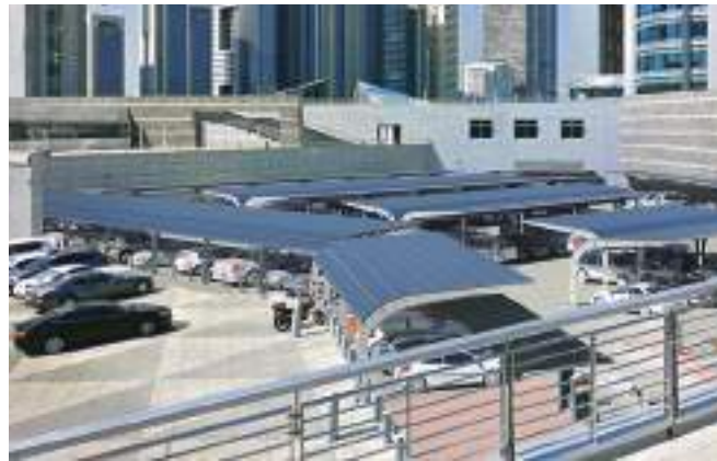
Zakrzywiony dach parkingowy ZEA | 273kW
