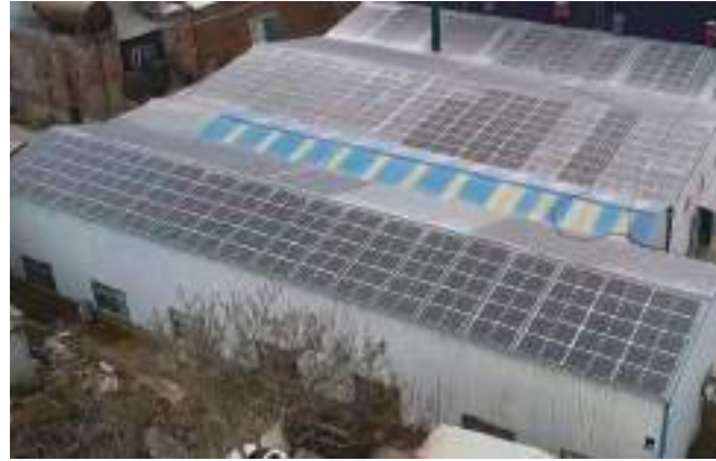
Dach o niskiej nośności Prowincja Henan, Chiny | 280kW
