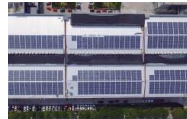
Dach o niskiej nośności Prowincja Jiangsu, Chiny | 600kW
