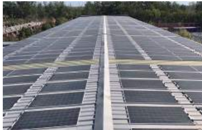
Dach o niskiej nośności Pekin, Chiny | 300kW
